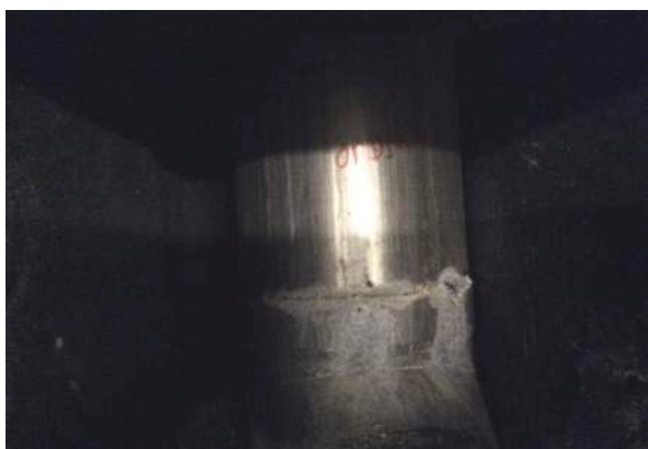
Lekkage door corrosie
